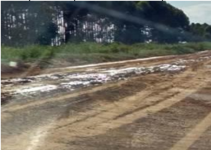
FIGURA 3.12 - Trecho do acesso existente bastante afetado pelas chuvas, impedindo o tráfego de caminhões que deverá ser recuperado com camada de revestimento primário
