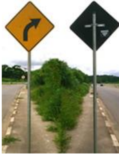
Figura 7.17 - Placa de sinalização com fixação por coluna PP, em tubo de aço galvanizado
